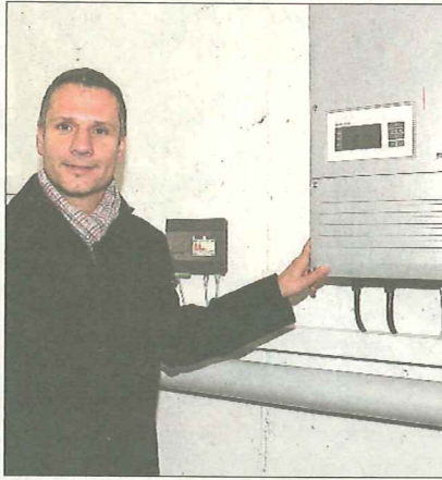
Martin Hillebrand im Technikraum vor dem Wechselrichter (Fotos: re)
