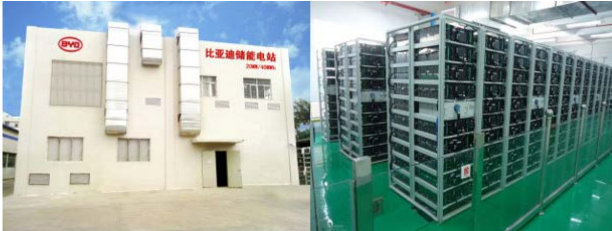
Quelle: BYD / Fenecon Batteriespeicher in Senzhen, China,
