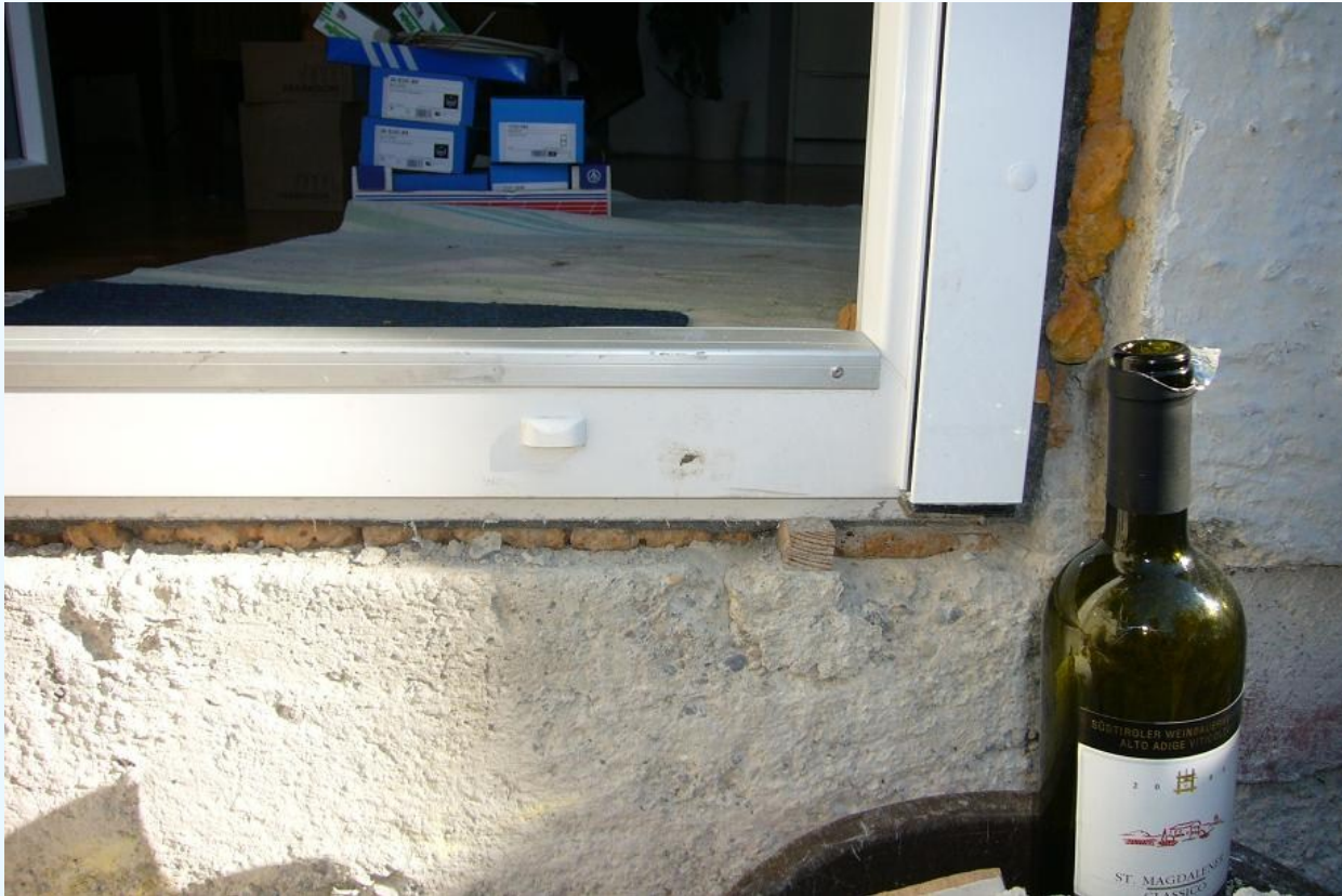
Unsachgemäßer Fenster- und Türeneinbau
