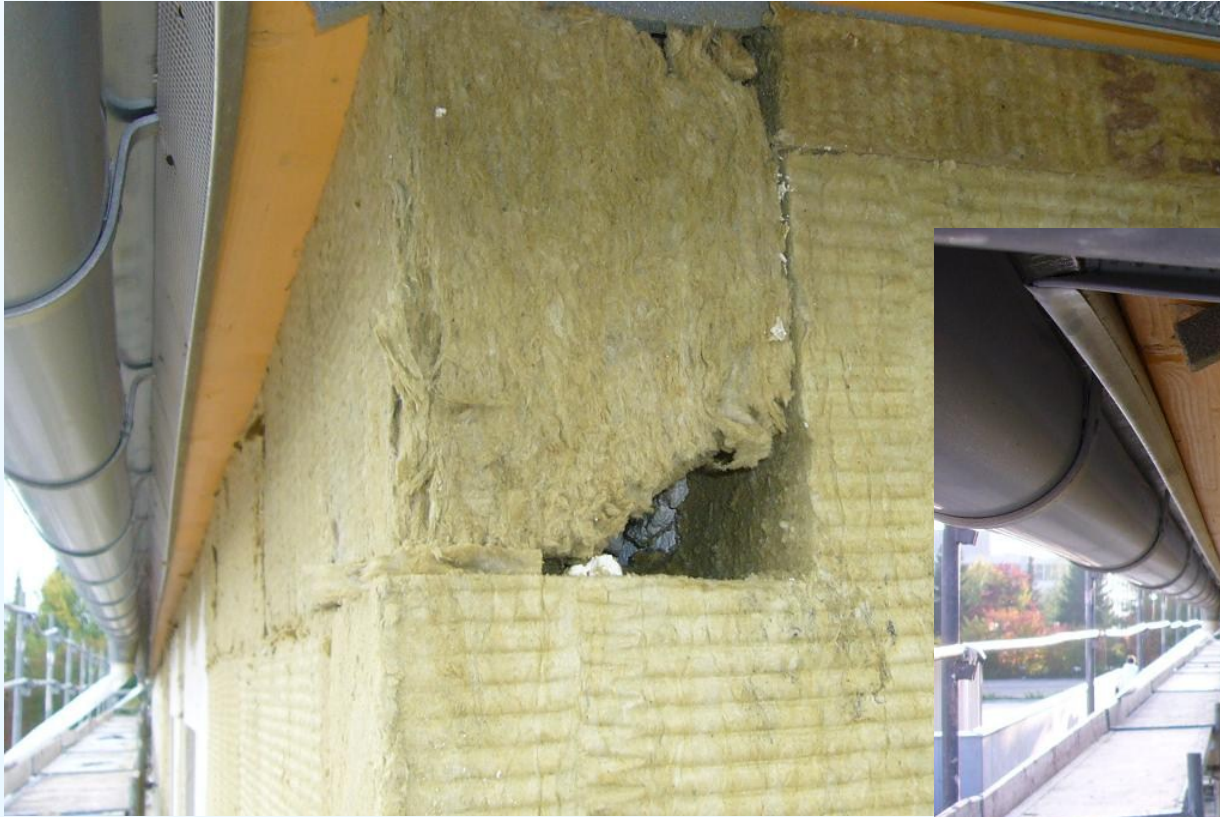
Wärmebrücken in der Außenfassade
