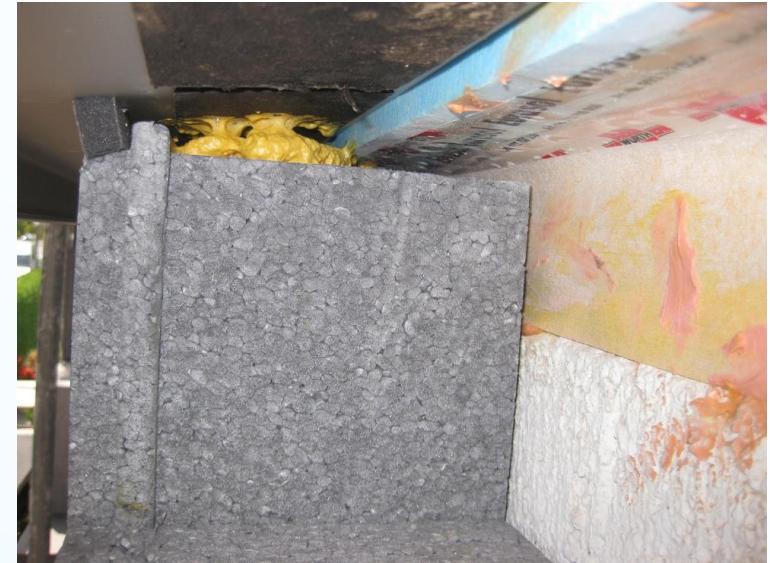
Hohlraum unter Fensterbank als Wärmebrücke
