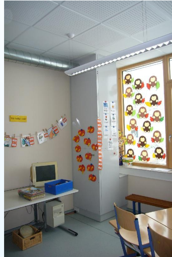
Dezentrales Lüftungsgerät in einer Schule
