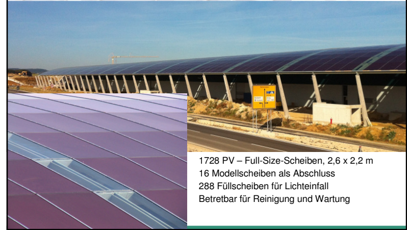
GVZ Ingolstadt: Größtes Photovoltaikglasdach weltweit
